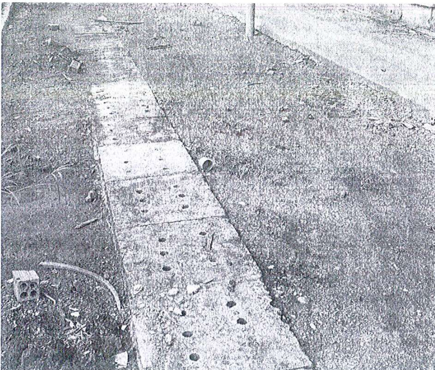
Mương thu gom nước thải từ HTXLKT lò hơi
