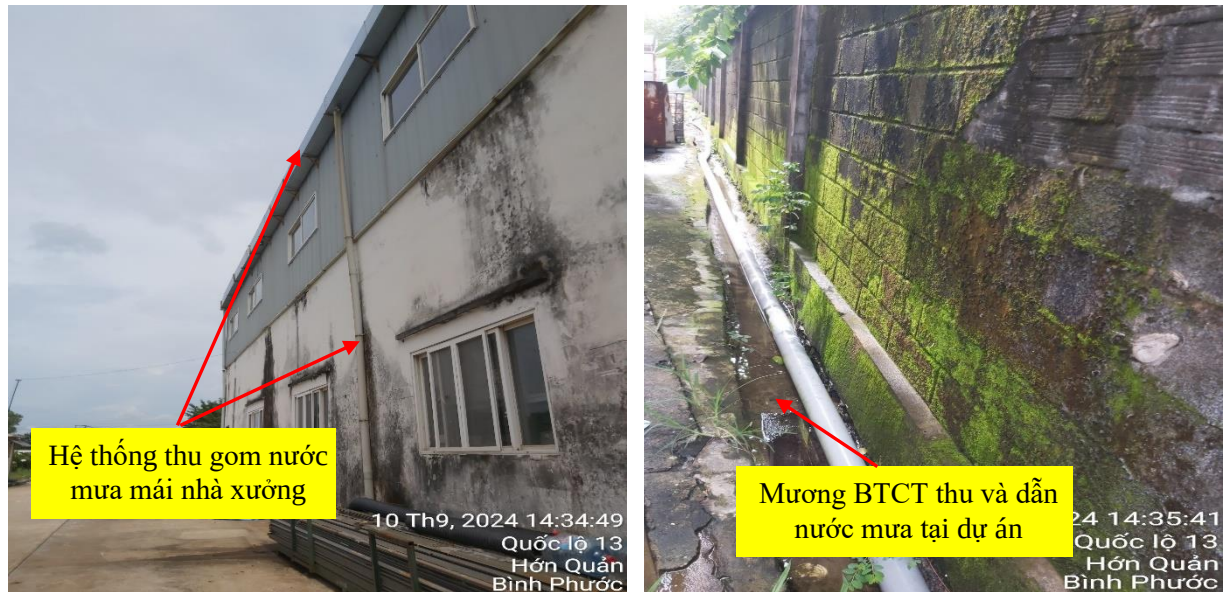
Hình 1.14. Hệ thống thu gom nước mưa thực tế tại nhà máy
