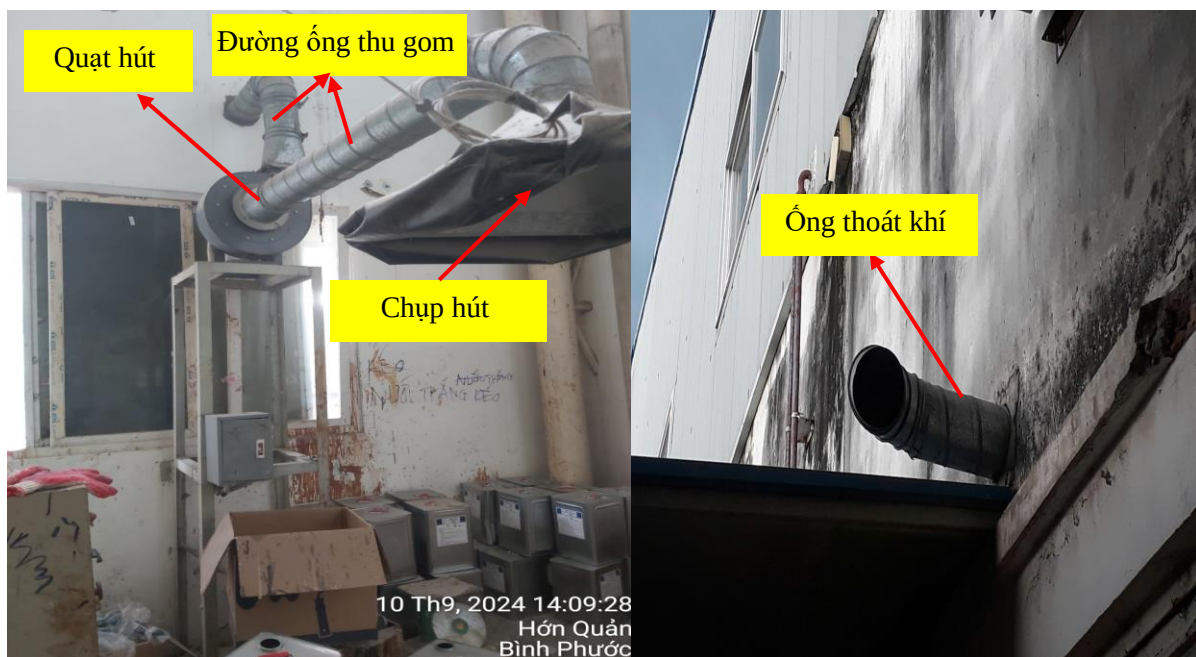
Hình 4.11. Quy trình và chụp hút ống dẫn có than hoạt tính xử lý hơi keo tại khu vực pha keo ABS
