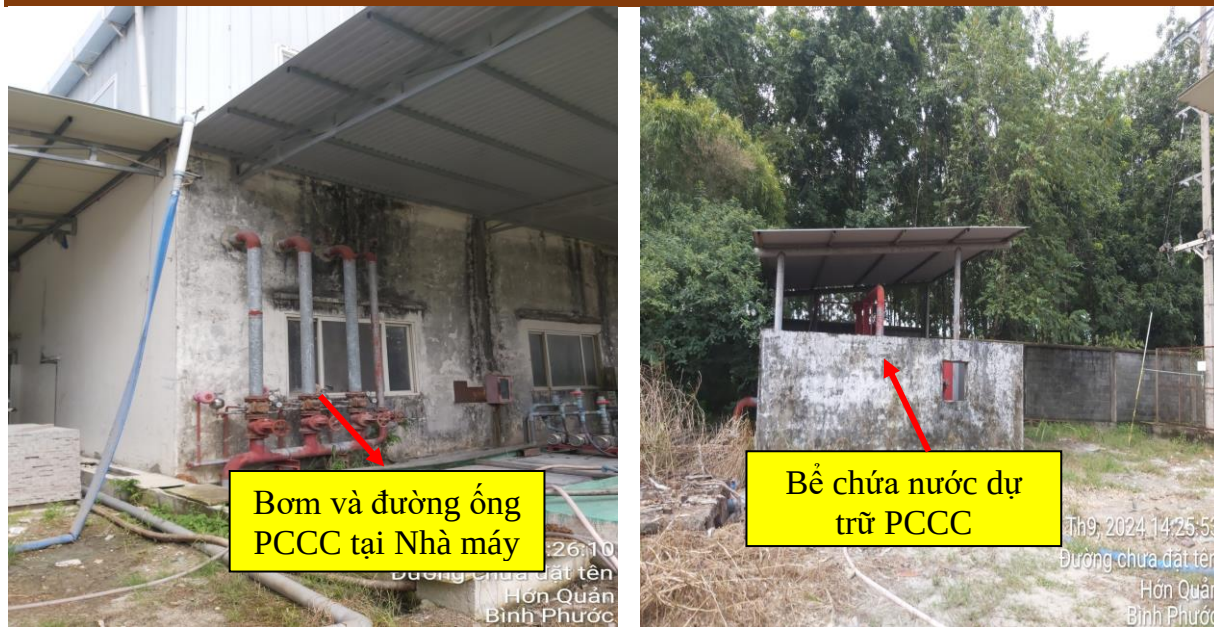
Hình 4.27. Một số hình ảnh thực tế hệ thống PCCC tại nhà máy
