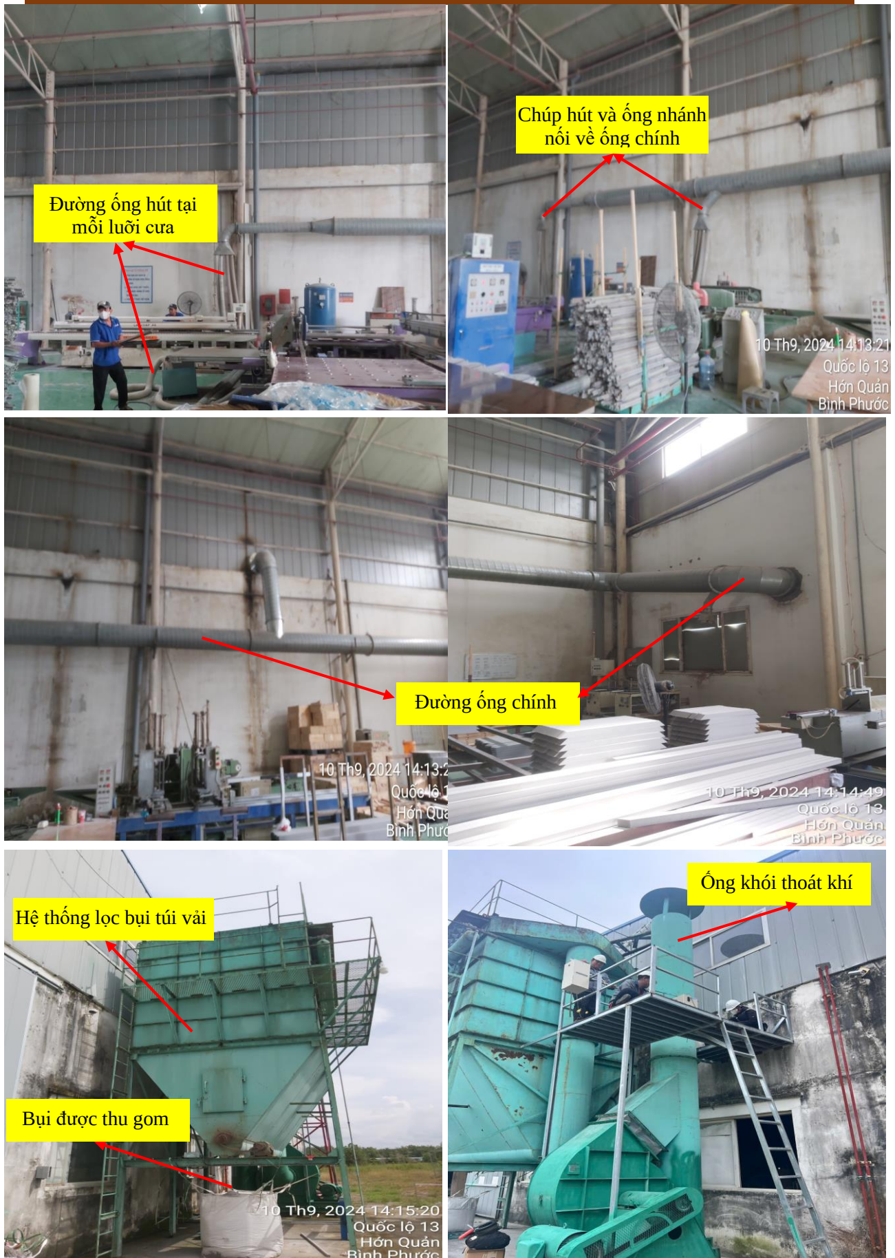
Hình 4.6. Hiện trạng hệ thống xử lý bụi công đoạn cưa hoàn thiện sản phẩm
