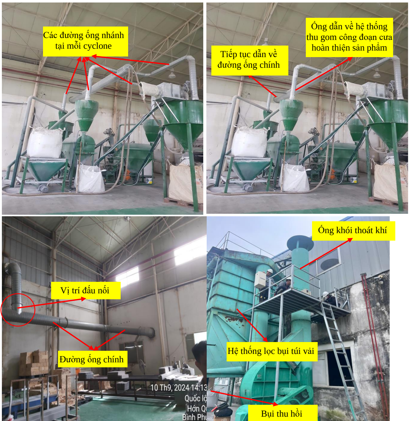
Hình 4.9. Hiện trạng thay đổi và thu gom xử lý bụi từ công đoạn sơ chế nhựa
