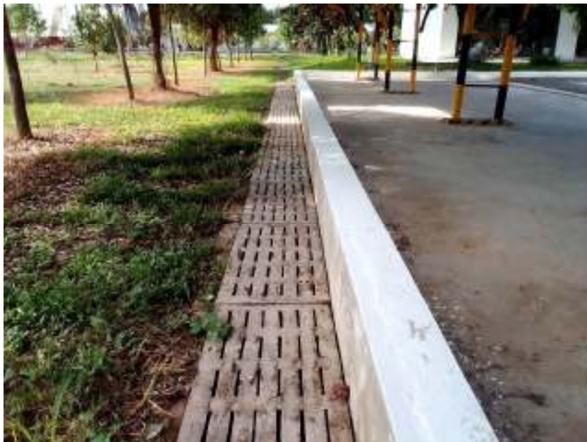
Hình 3. 2. Hình ảnh hệ thống thoát nước mưa
