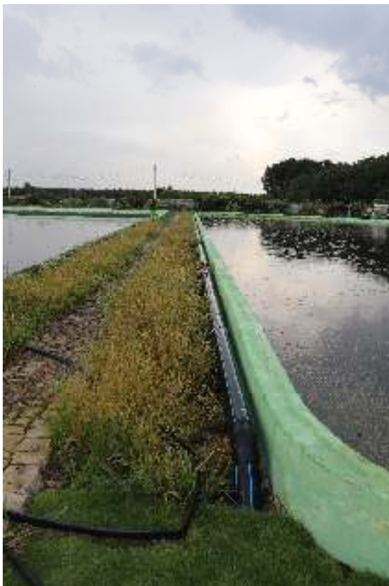
Đường ống dẫn khí biogas về trạm máy phát điện
