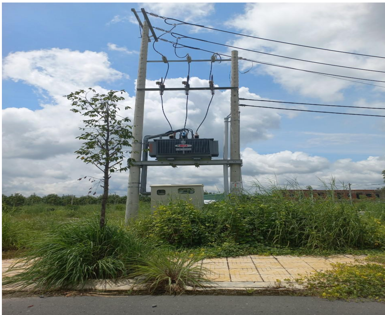
Hình 1.3. Trạm biến áp Khu dân cư Đất Xanh
