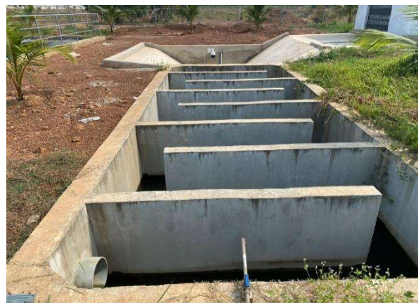
Bể khử trùng
