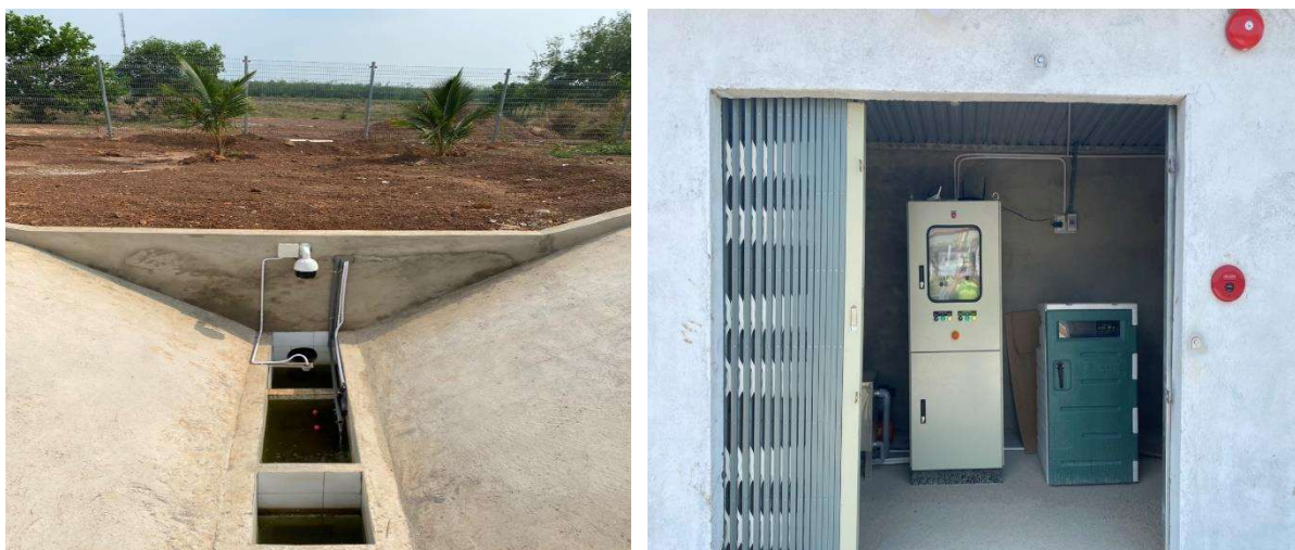
Hình 3. 6. Hình ảnh trạm quan trắc nước thải tự động, liên tục của Trạm XLNTTT KCN Đồng Xoài III
