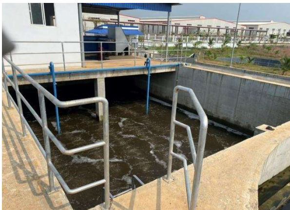
Bể điều hoà
