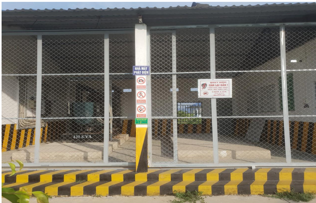
Hình 3.10. Nhà đặt máy phát điện
