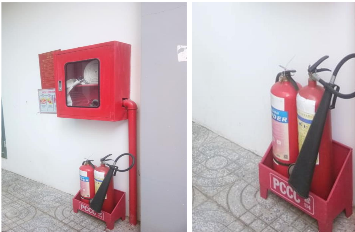
Hình 3.11. Các thiết bị phòng cháy chữa cháy của dự án
