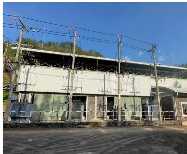
Trạm biến áp truyền tải điện
