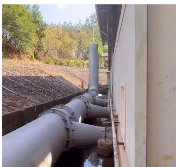
04 nhánh ống dẫn vào 4 turbin, bình nén khí
