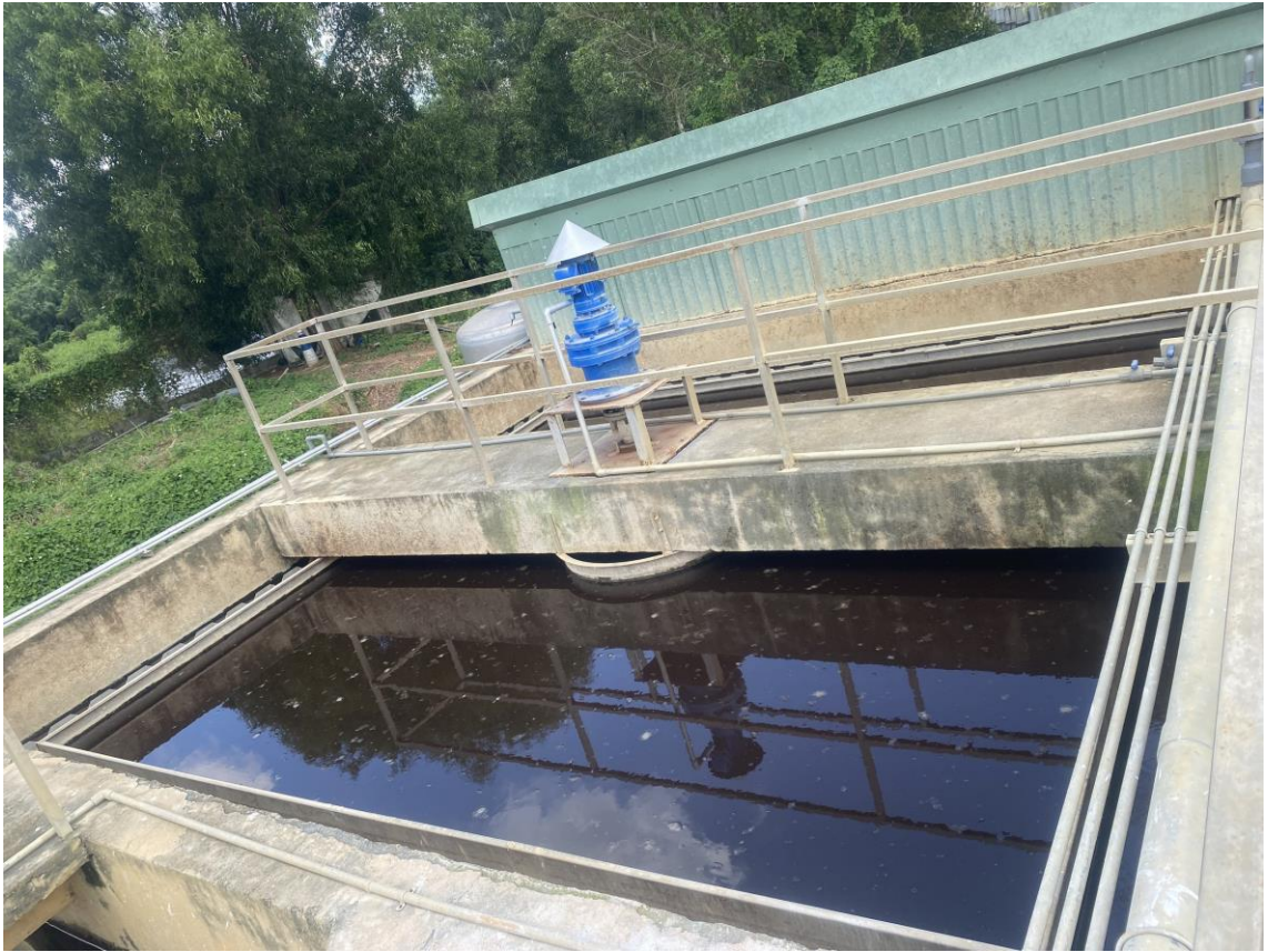
Bể lắng sinh học
