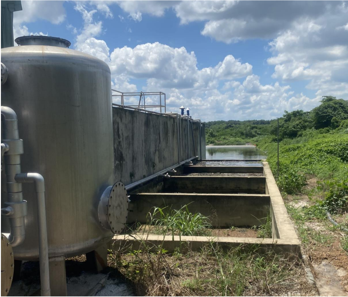
Bể nén bùn
