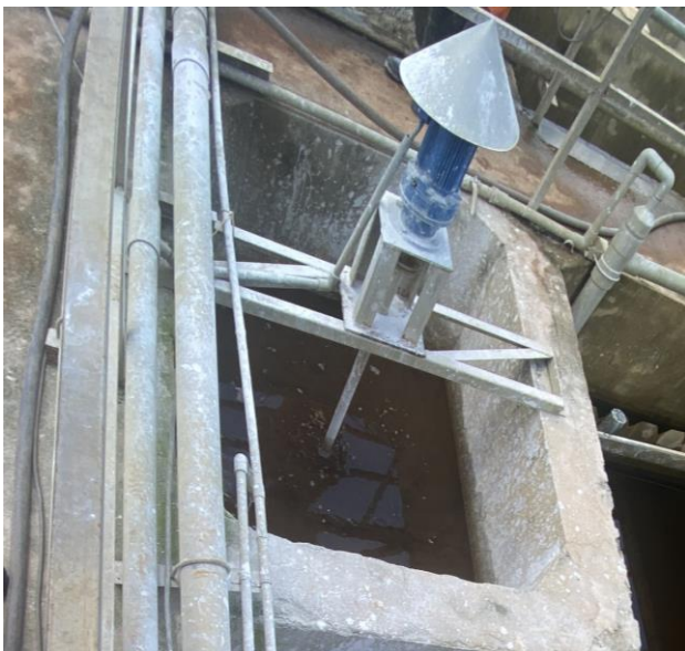
Bể keo tụ
