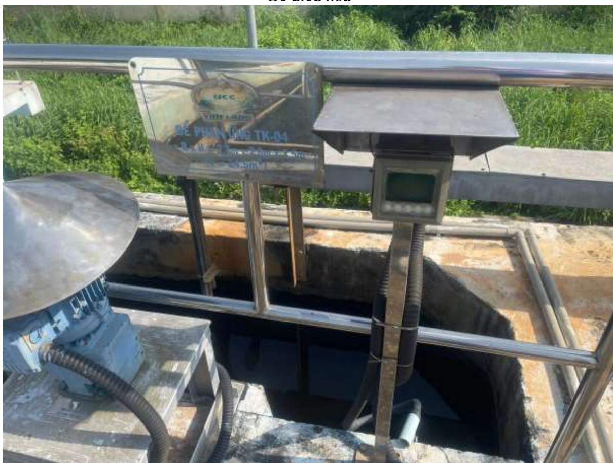
Bể phản ứng
