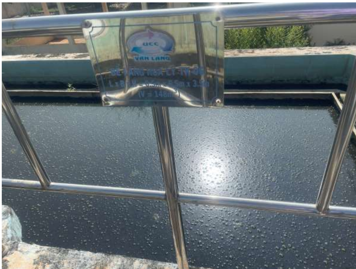
Bể lắng hóa lý
