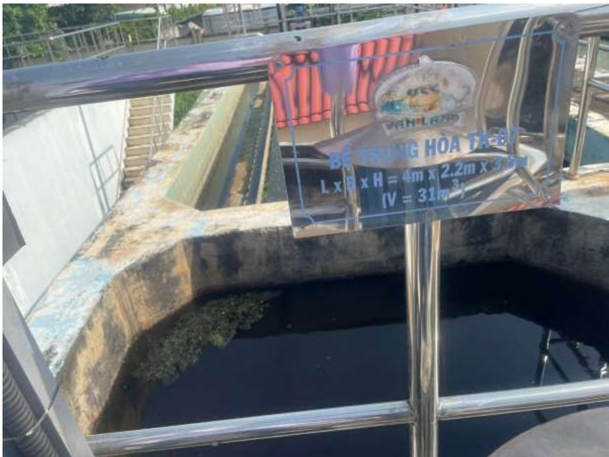
Bể trung hòa
