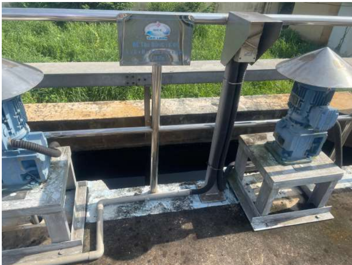
Bể keo tụ, tạo bông
