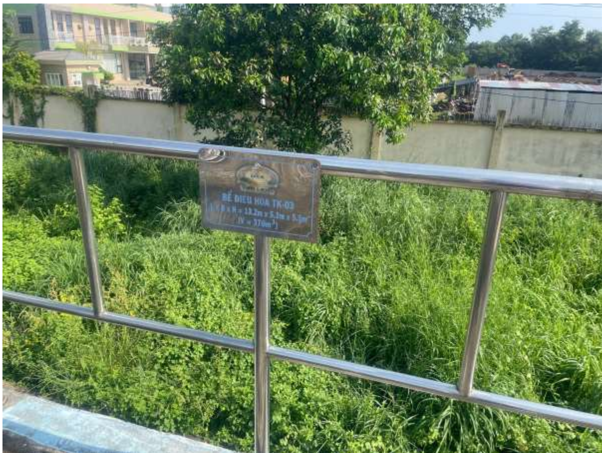
Bể điều hoà
