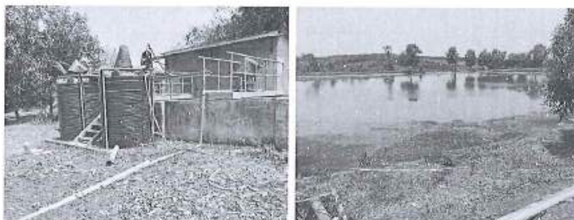
Hình 3.6. Một số hình ảnh của hệ thống xử lý nước thải
