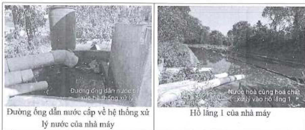
Hình 1.6. Một số hình ảnh hệ thống xử lý nước cấp của nhà máy
