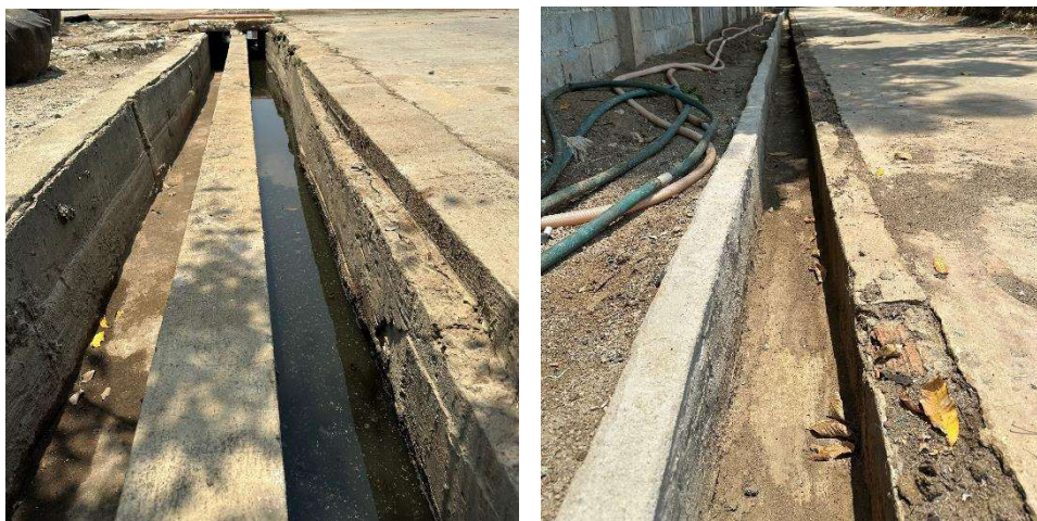
Hình 3.4. Mương hở thu gom nước thải và nước mưa nhiễm bẩn của nhà máy
