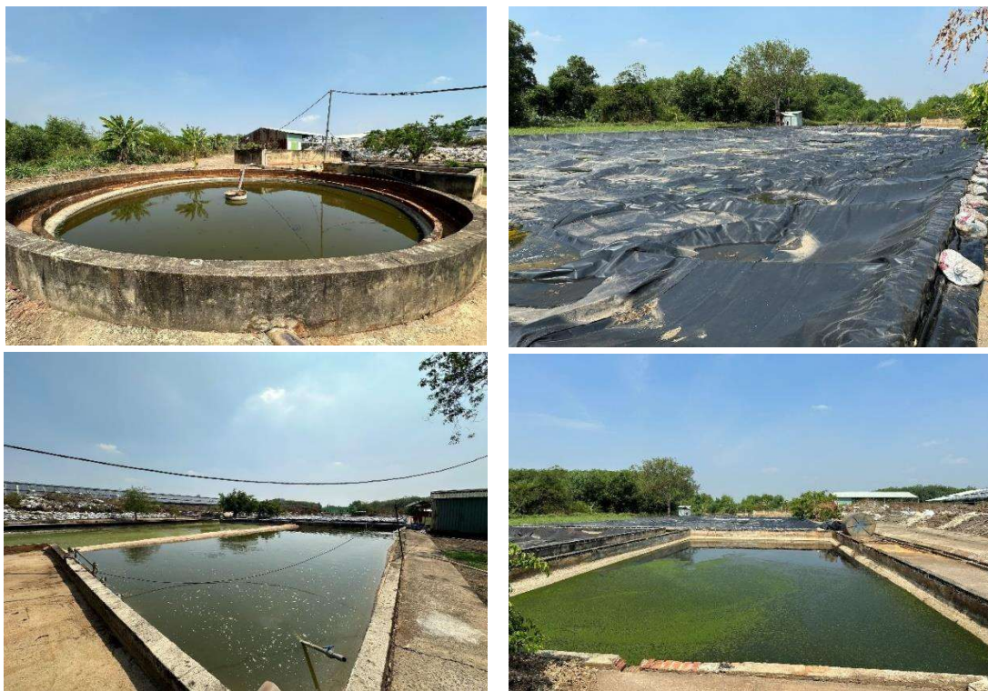
Hình 3.8. Hệ thống xử lý nước thải công suất 150 m 3 /ngày.đêm
