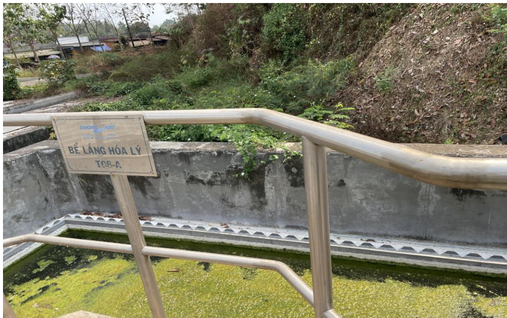
BỂ LẮNG HÓA LÝ
