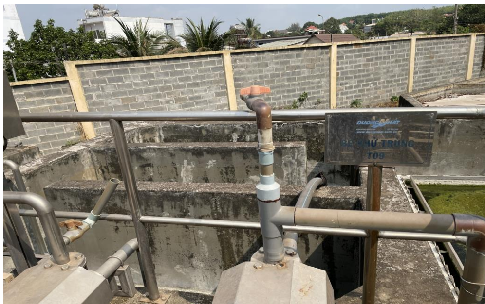
BỂ KHỬ TRÙNG
