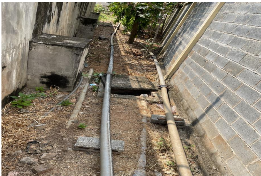
Hình 3. 6 Hồ ga nước thải sau xử lý dẫn ngầm qua đường nhựa
