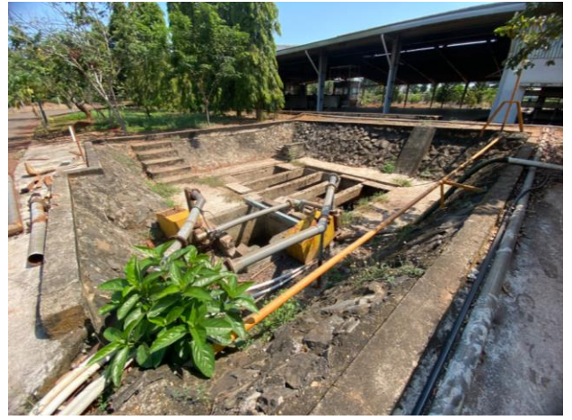
Hố thu (nước thải từ xưởng chế biến mủ côm từ mủ nước)
