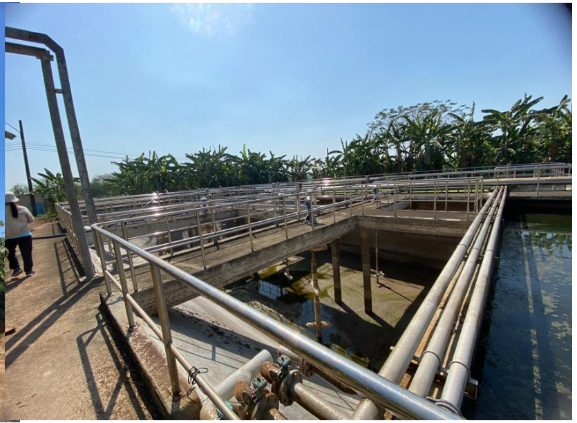
Bể Anoxic T09-A
