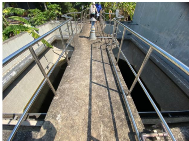
Bể lắng hóa lý
