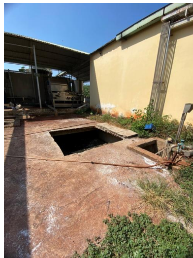
Bể điều hòa
