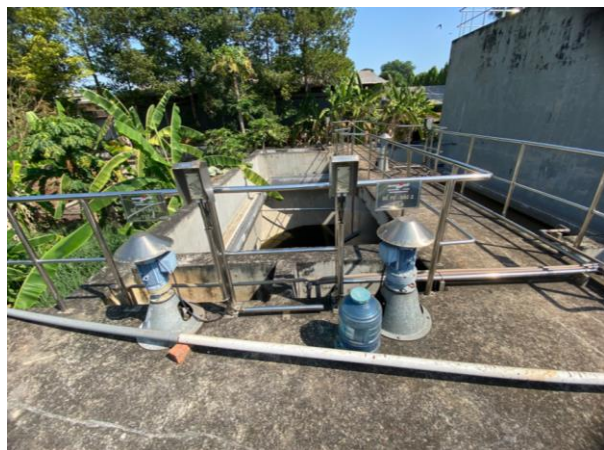
Bể keo tụ - tạo bông 2
