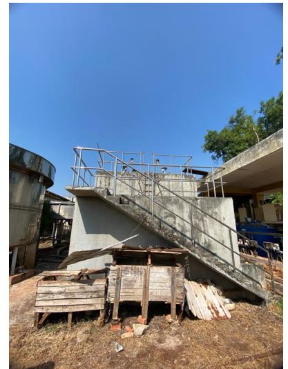
Bể keo tụ - tạo bông 1
