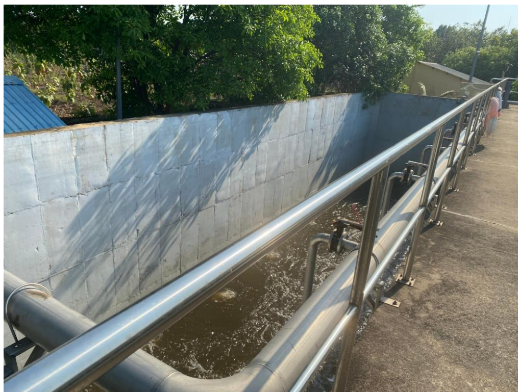
Bể điều hoà
