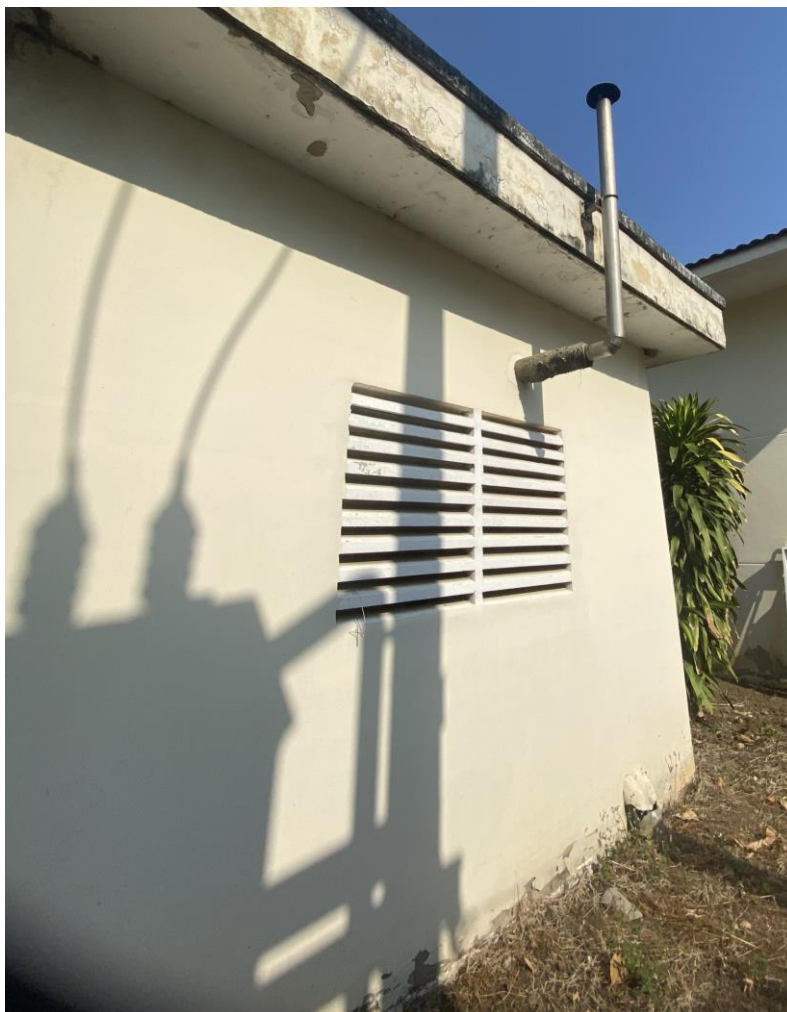
ống khói máy phát điện
