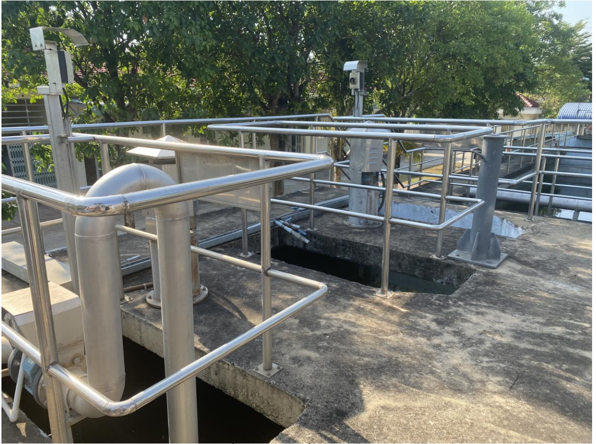
Bể keo tụ - bể tạo bông
