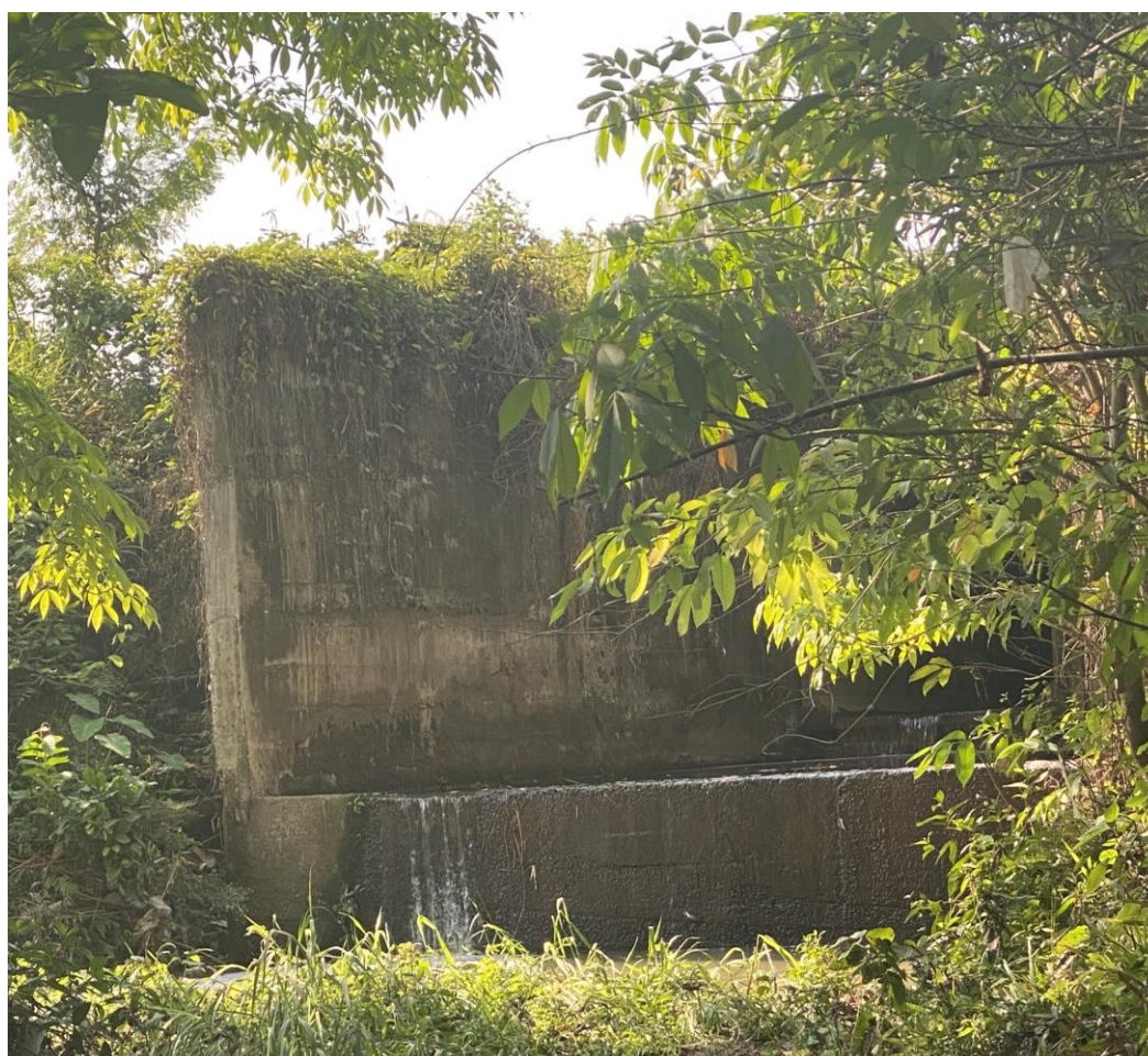
Miệng xả nước mưa của KCN, khu A
