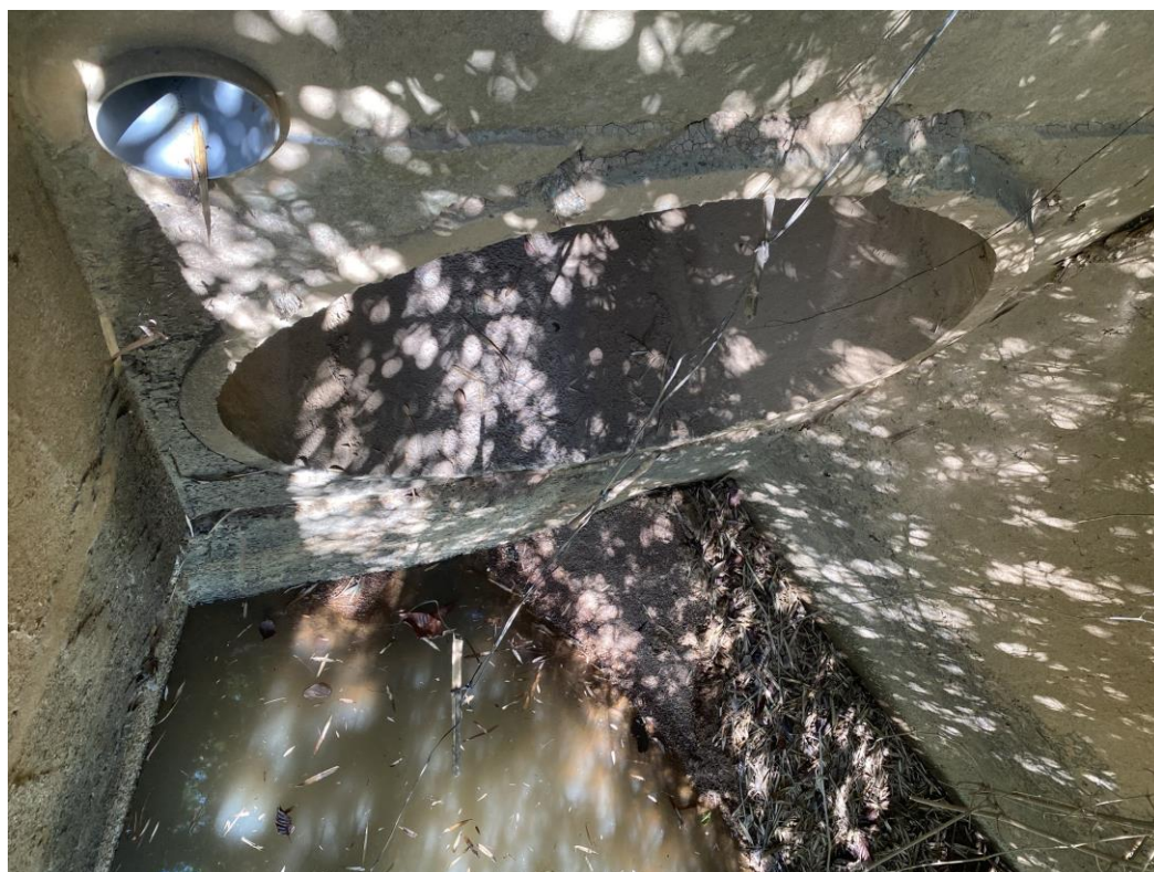
M iệng xả nước thải KCN, miệng xả nước mưa KCN, khu B
