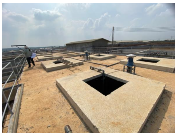
Bể kỵ khí (UASB)
