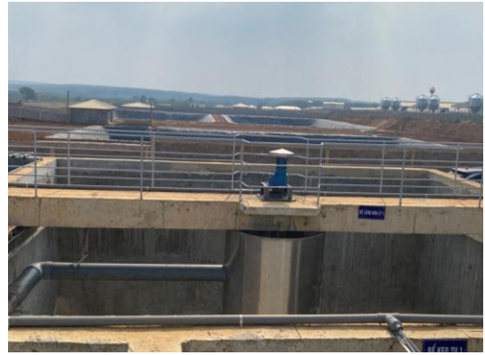
Bể lắng hóa lý 1 (bể lắng bùn hóa lý 1)
