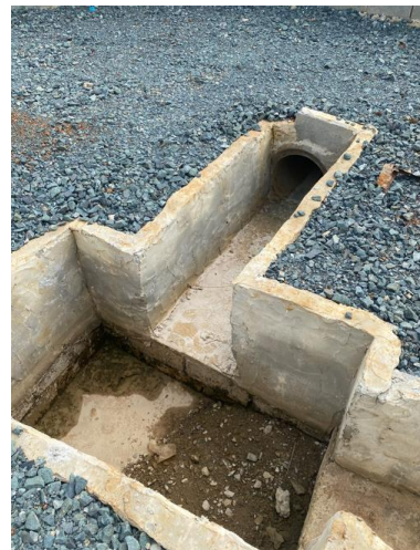
Hình 3. 3: Hố ga thu gom nước mưa
