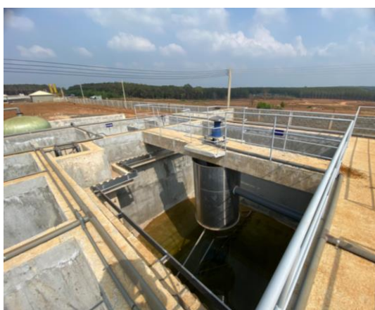
Bể lắng hóa lý 2 (bể lắng bùn hóa lý 2)
