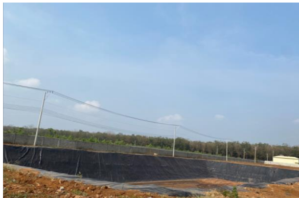
Hình 3. 4: Các hồ chứa nước mưa (4 hồ)
