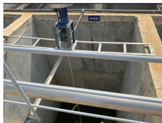
Bể keo tụ 1
