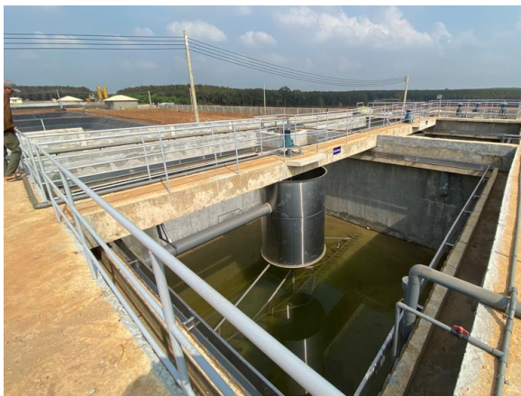
Bể lắng sinh học (Bể lắng bùn sinh học)
