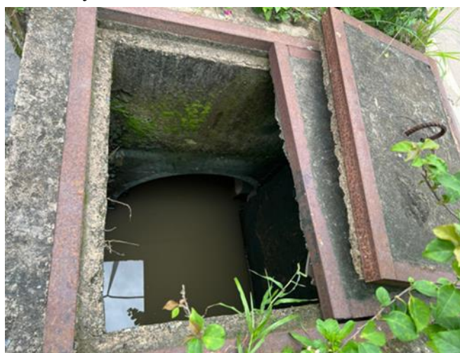
Hình 3.3. Hồ ga thoát nước mưa tại Dự án
