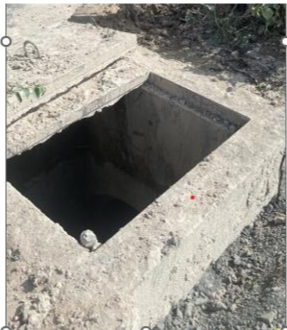
Hình 3.2. Hố ga được đầu nối của hệ thống thoát nước chung của khu vực nằm trên đường Minh Hưng – Đồng Nơ
