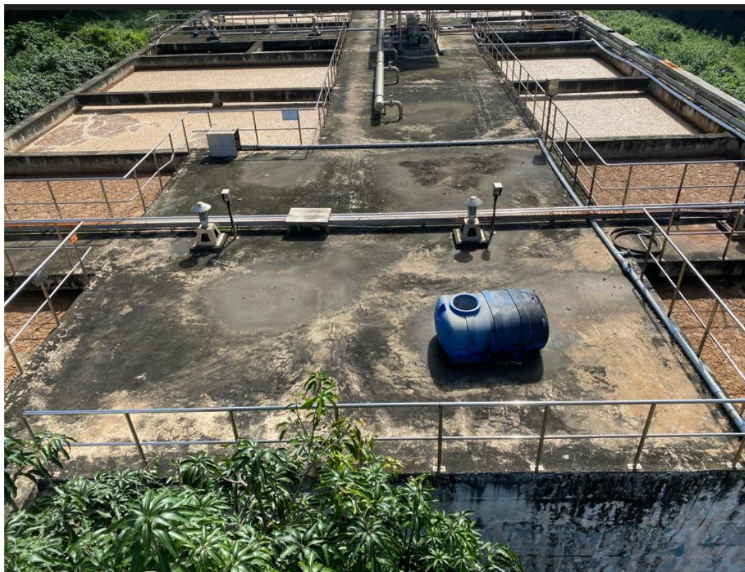
Hình 21: Cụm Bể Anoxic (T10A, T10B), Bể hiếu khí (T11A, T11B)
