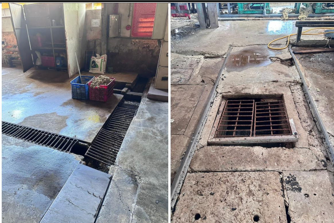
Hình 3. 7: Hình ảnh thực tế mương và hố ga thoát nước thải mủ nước
