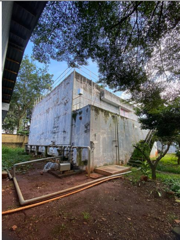
Hình 20: Bể phân phối khí (T08) và UASB (T09)
