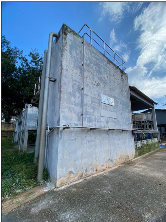
Hình 18: Bể keo tụ - tạo bông (T07)
