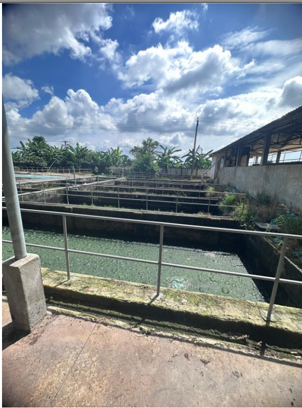
Hình 3: Bể điều chỉnh pH
