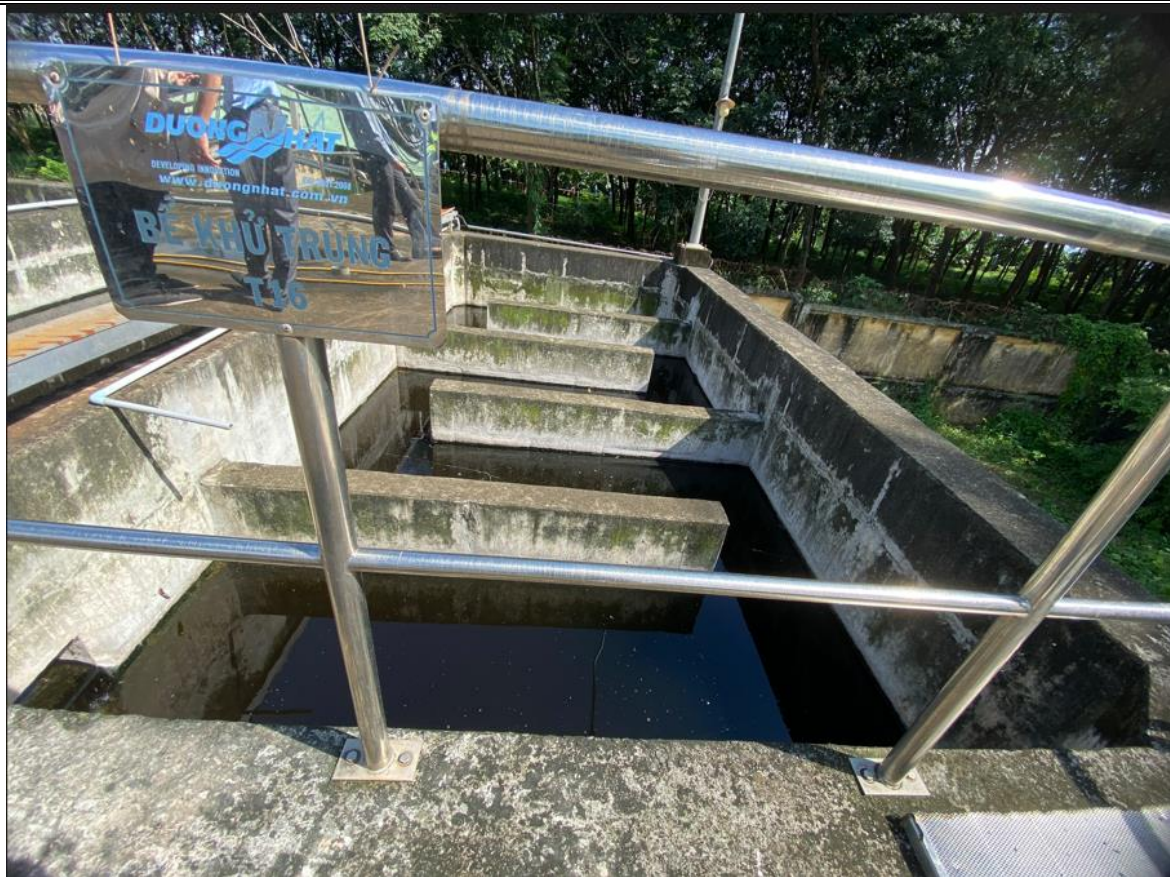
Hình 26: Bể khử trùng T16
