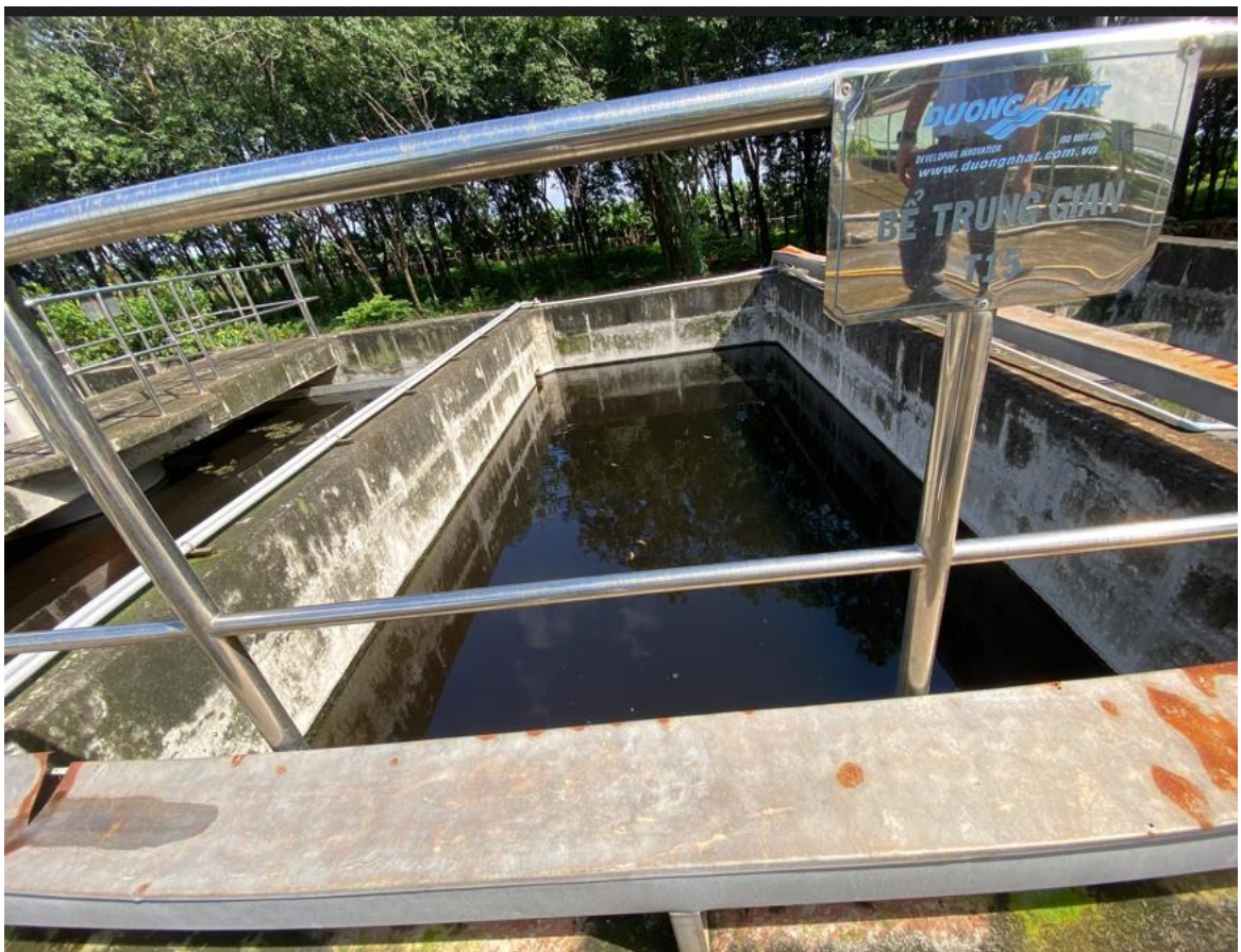
Hình 25: Bể trung gian T15
