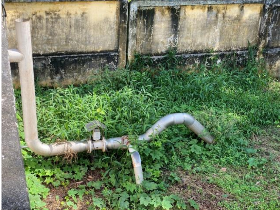
Hình 3. 4: Đường ống đầu nối nước thải sau xử lý
