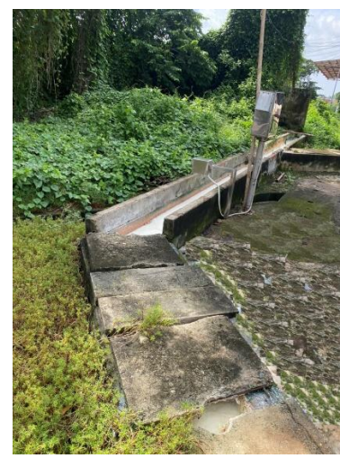
Mương dẫn nước thải về HTXLNT tập trung
