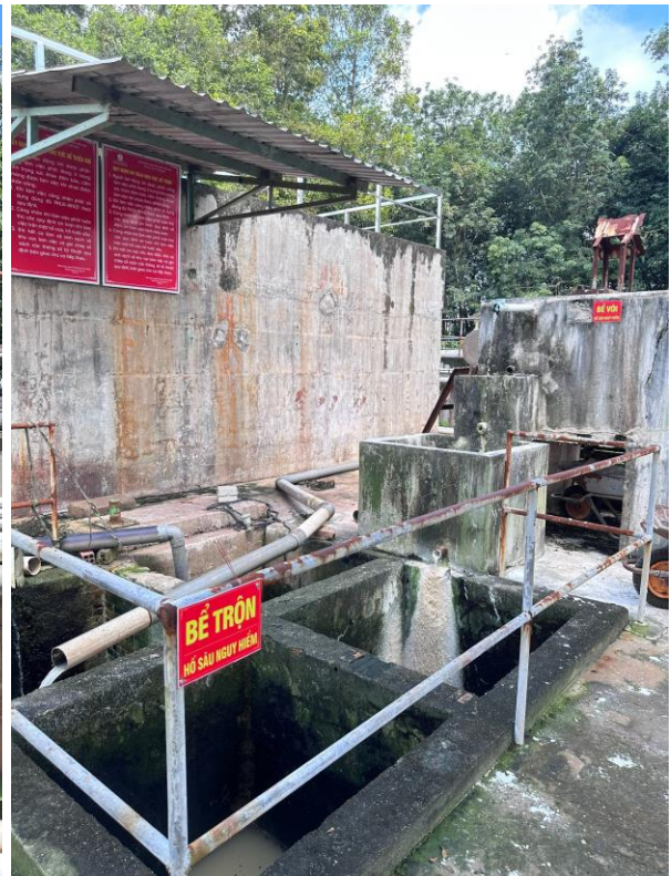
Hình 6: Bể trộn + bể vôi
