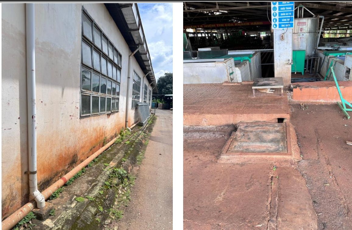
Hình 3. 2: Hình ảnh thực tế mương và hố ga thoát nước mưa
