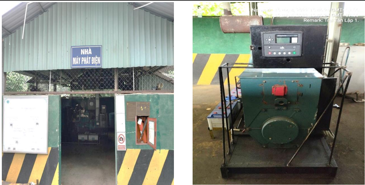
Hình 3.6. Máy phát điện dự phòng
