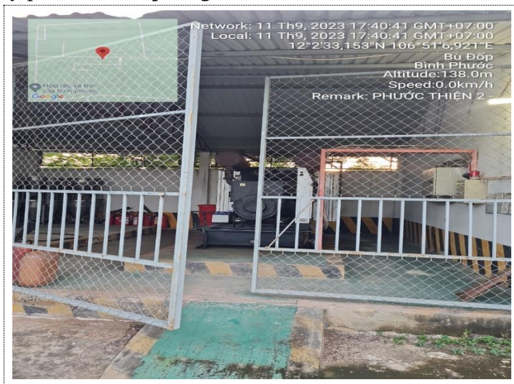
Hình 3.5. Nhà đặt máy phát điện tại cơ sở
