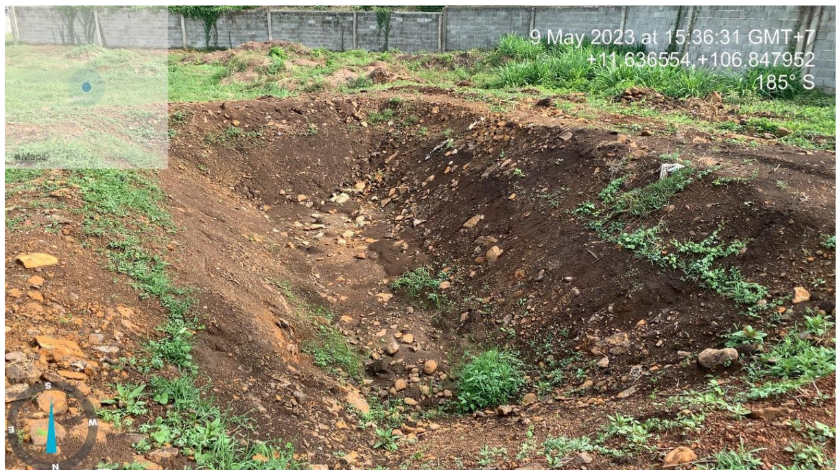
Hình: Mương thu nước mưa và hồ chứa nước mưa tại trại
