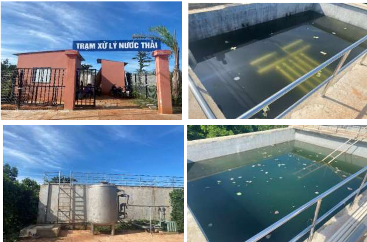
Hình 3.6. Trạm xử lý nước thải tập trung giai đoạn 1 công suất 300 m 3 /ngày.đêm
